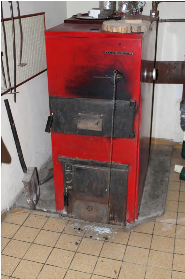
Bild 19: Festbrennstoffheizung in der Schmutzschleuse im EG
