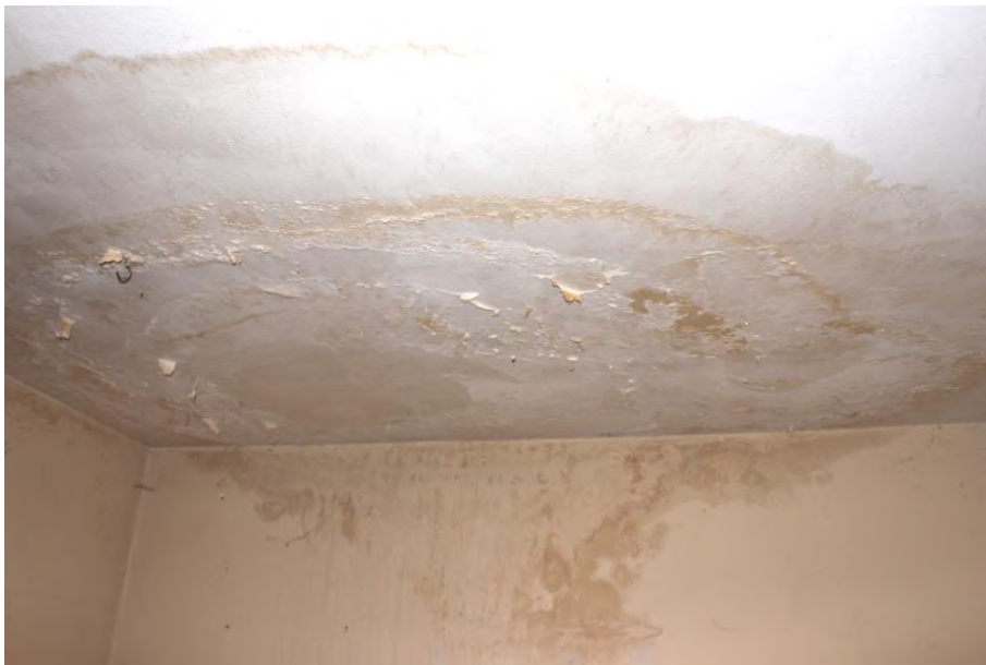
Bild 24: behobener Feuchteschaden im Durchgangszimmer zum OG der Garage
