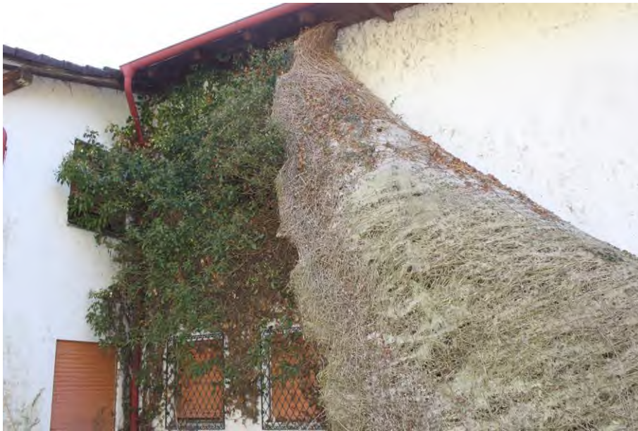
Bild 5: Großflächig abgelöster Fassadenbewuchs an der Nordseite des Wohnhauses
