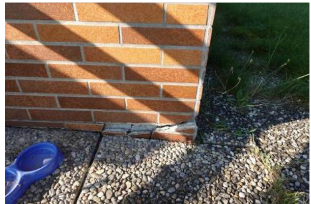
Instandsetzungsbedürftiger Fliesensockel der Fassade
