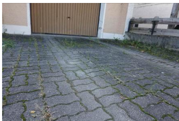
Instandsetzungsbedürftige Grundstückszufahrt zur Garage
