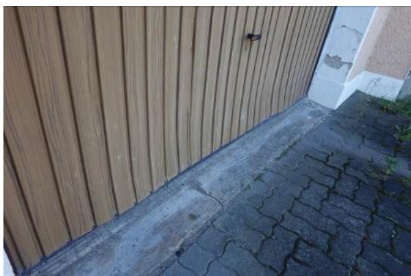
Erneuerungsbedürftiges Garagentor der Garage
