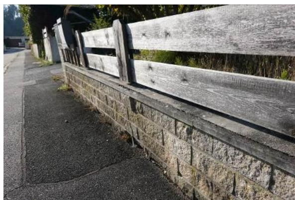
Instandsetzungsbedürftige straßenseitige Einfriedung
