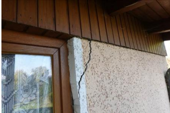
Signifikante Risse an der Nordostfassade der Garage
