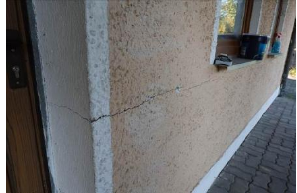
Signifikante Risse an der Nordostfassade der Garage
