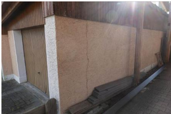
Signifikante Risse an der Südwestfassade der Garage
