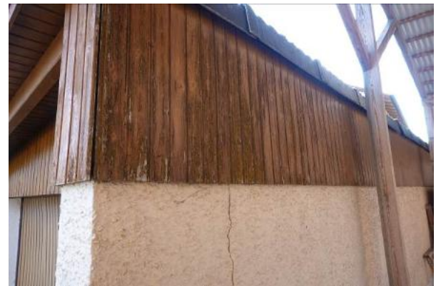
Instandsetzungsbedürftige Fassade der Garage
