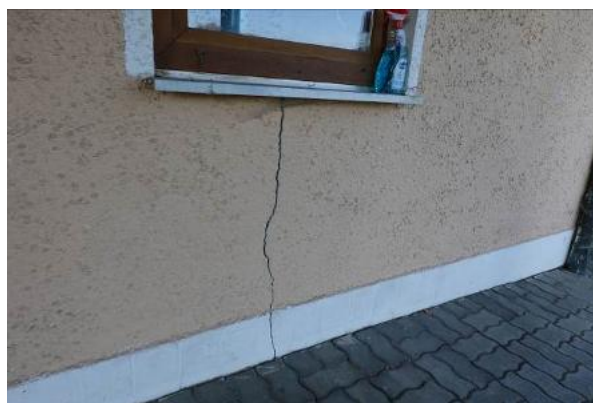
Signifikante Risse an der Nordostfassade der Garage
