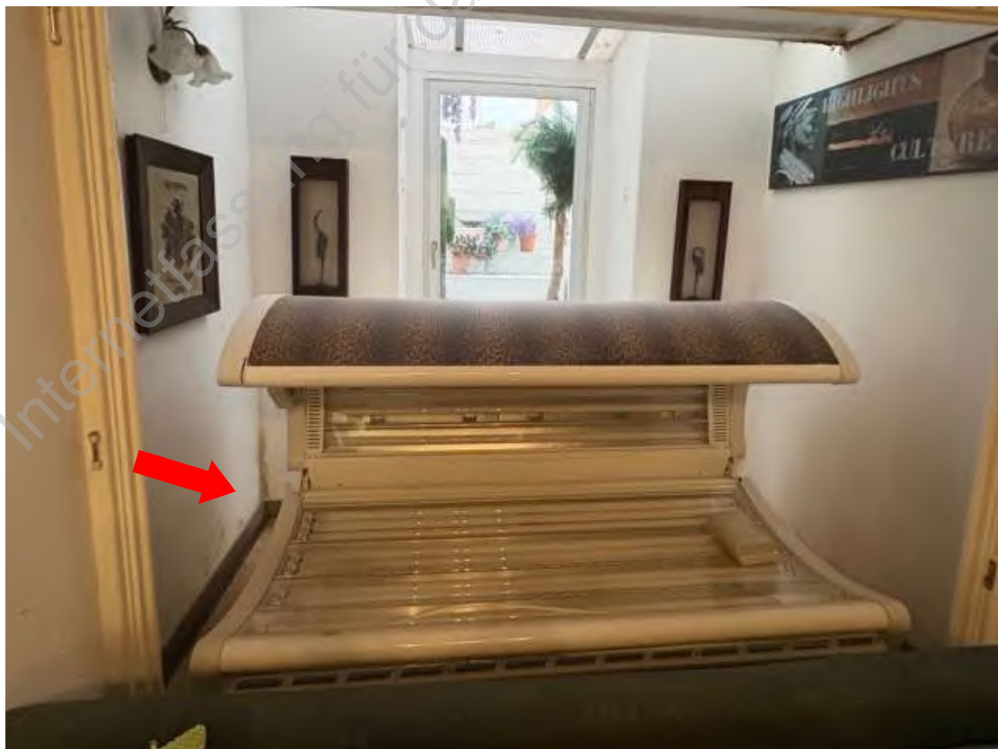
Foto 34: Feuchtigkeitseinwirkungen im begehbaren Lichtschacht
