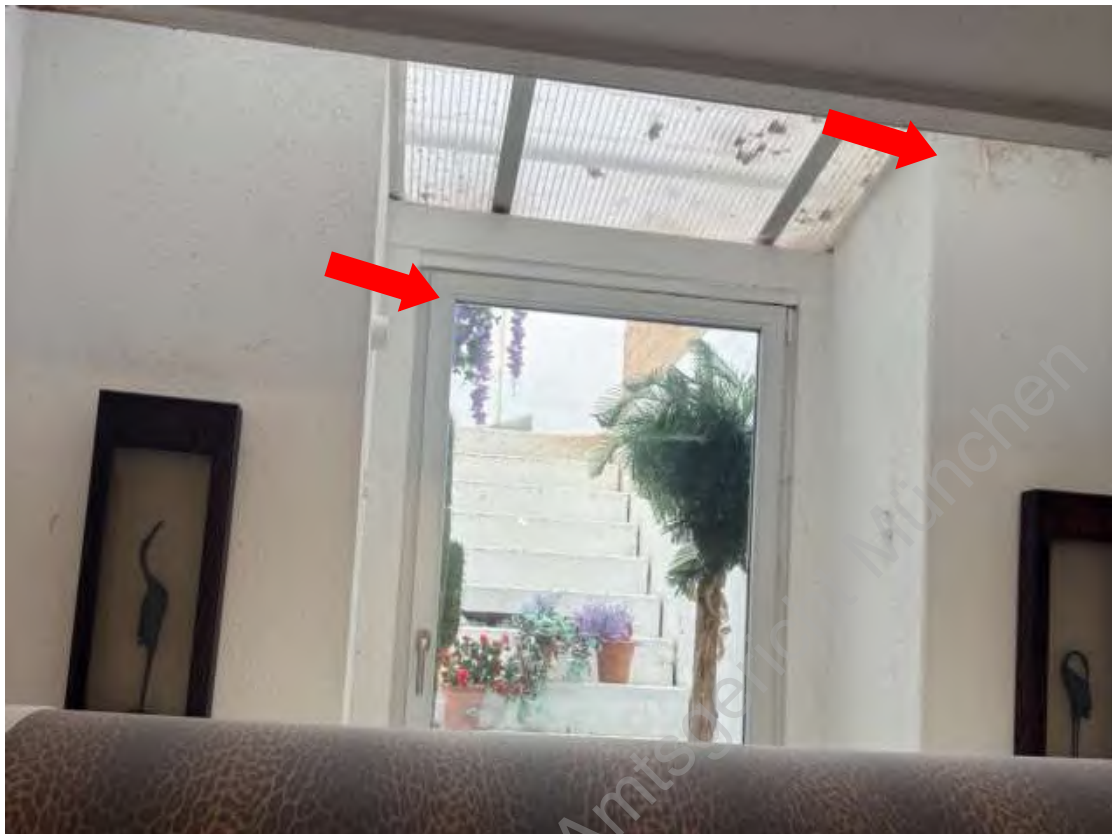
Foto 35: eingebaute Kunststofftür, Feuchtigkeitseinwirkungen
