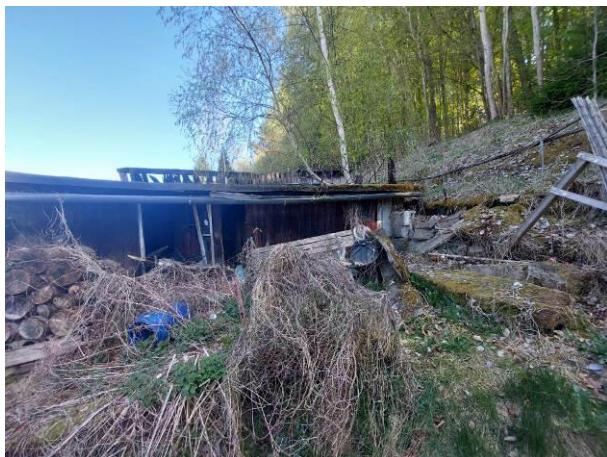
Holzverschlag / schadhafte Stützmauer / vermüllte und verwilderte Freifläche
