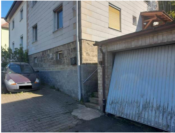
schadhafte Freifläche und Pflaster
