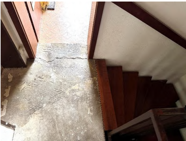
Vorplatz DG Estrich Beschädigung
