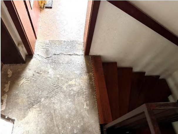
Vorplatz DG Estrich Beschädigung
