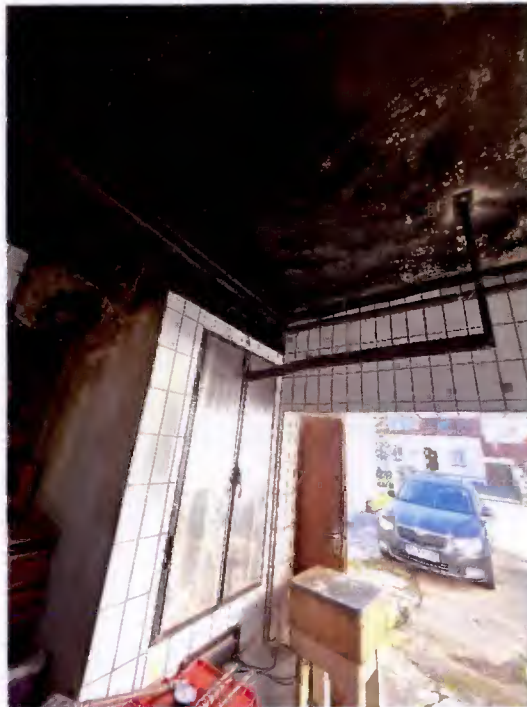
Raum „Vorbereitung“ mit Räucherkammer, Warmrauch
