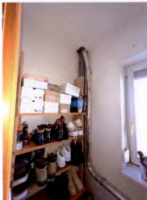
Abstellraum im Obergeschoss: unsachgemäße Leitungsführung
