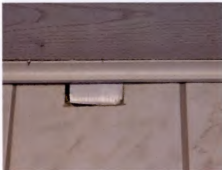
Erdgeschossbad: Anschlussbereich Wand - Decke
