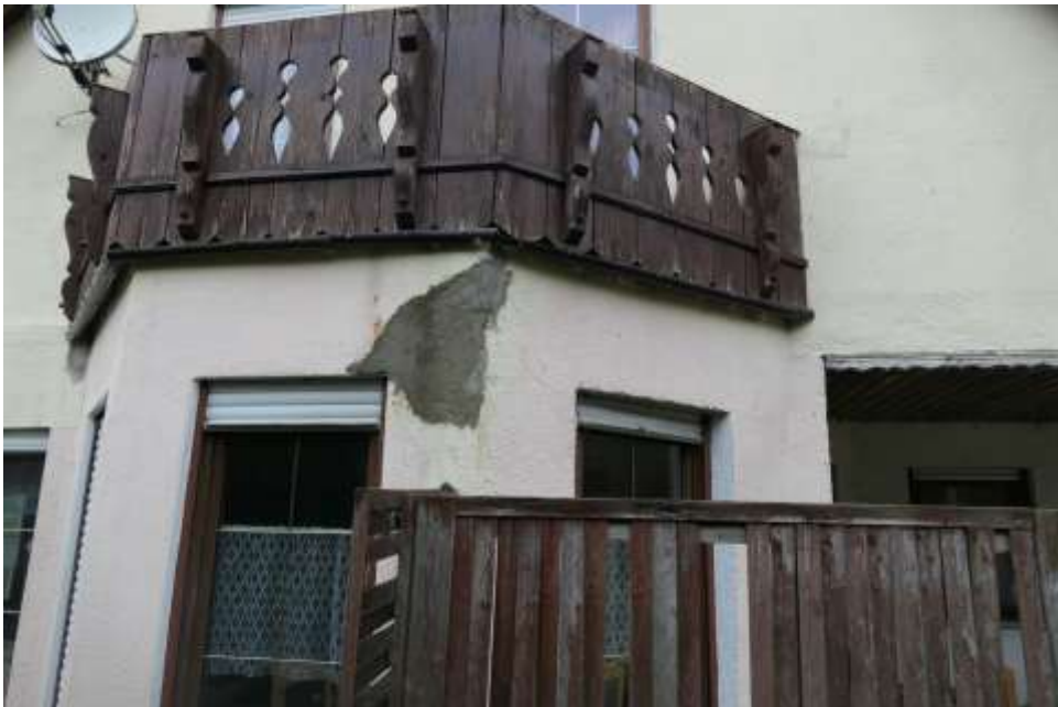
Bild 2: Giebel mit Balkon und Wasserschaden an der Fassade
