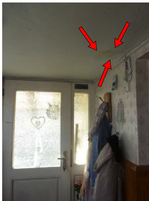
Feuchtigkeitschäden im Windfang an der Deckenuntersicht
