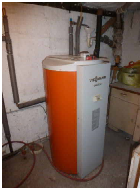
Warmwasserspeicher im KG
