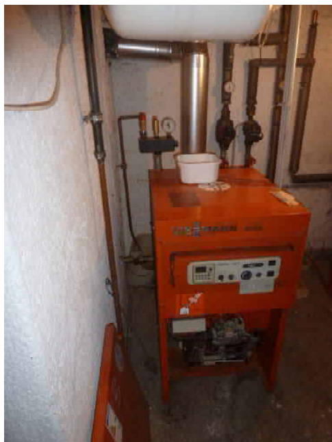
Heizung im KG
