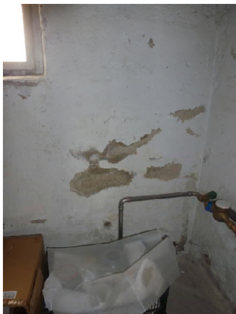
Putzschäden an der KG-Außenwand
