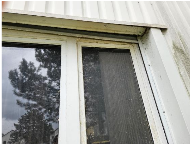
Augenscheinlich defekter Rollladen ETW 7
