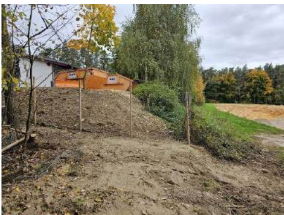
fehlende Einfriedungsanlagen an nordwestlicher Grundstücksgrenze
