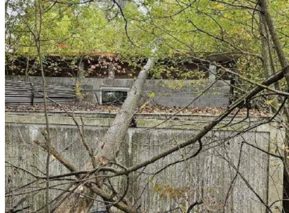
umgestürzter Baum auf Container und Gebäudedach
