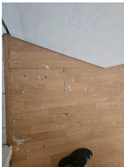
SE-Nr. 1 Wohnzimmer (Dokumentation der Schäden am Fußboden)
