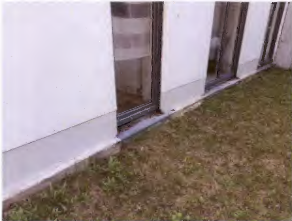
Bewertungsobjekt fehlende Terrasse
