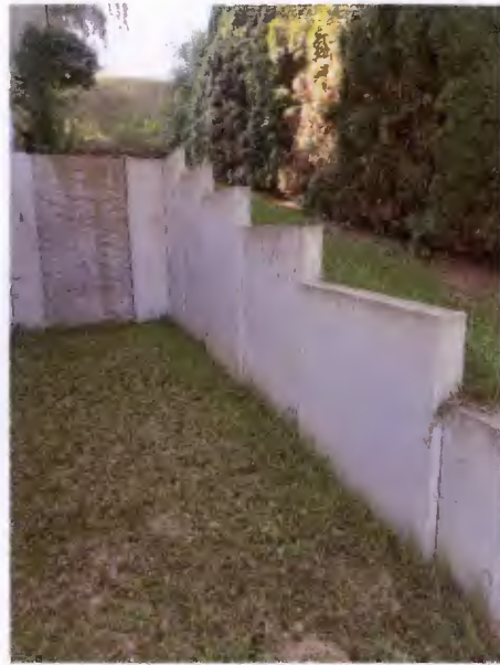
Bewertungsobjekt fehlende Terrasse mit vorhandene Stützwände
