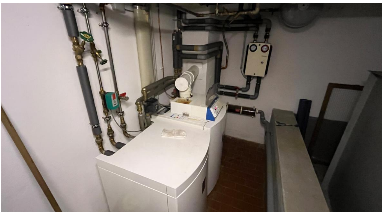
Blick auf die Heizungsanlage im Kellergeschoss
