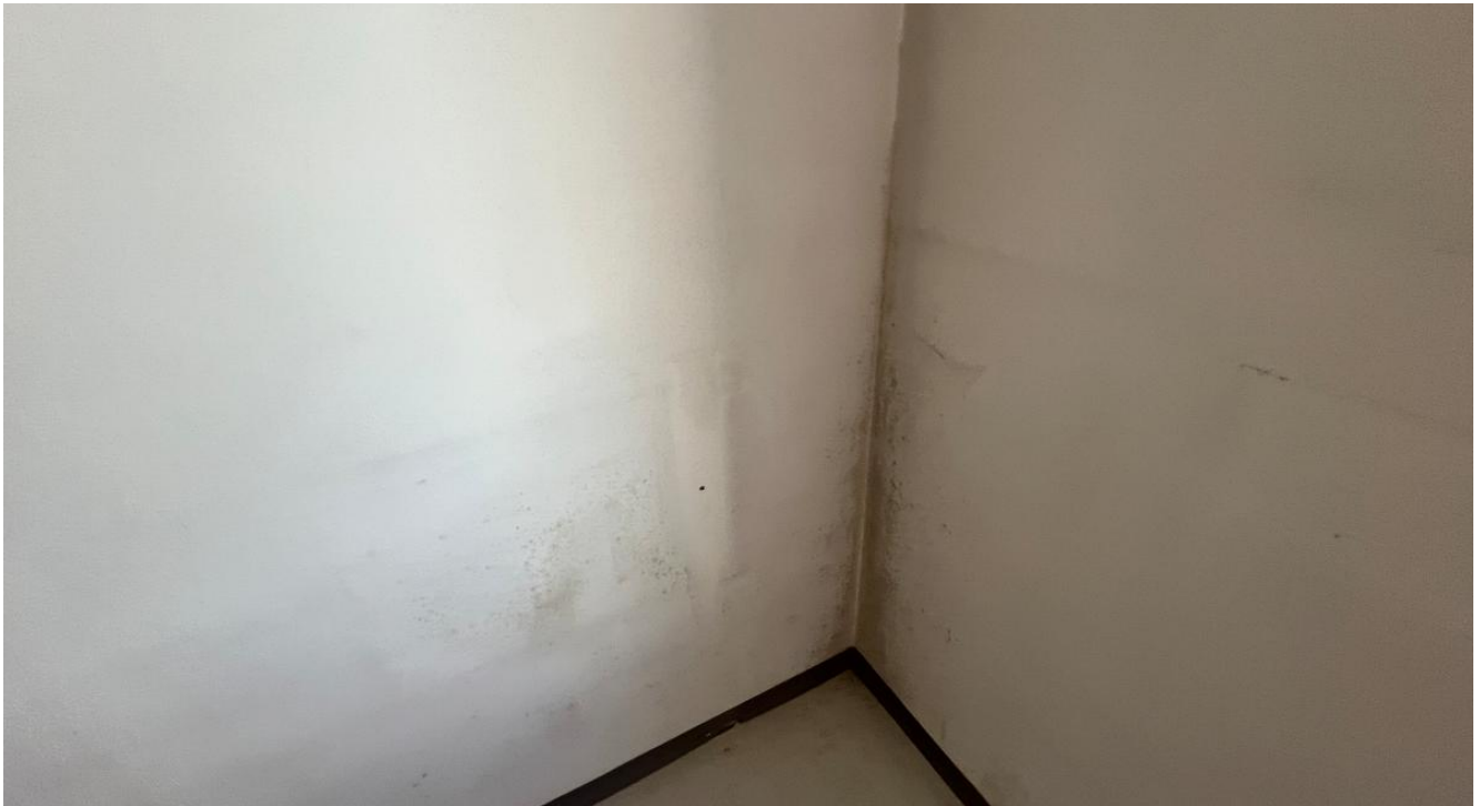
Blick auf einen Feuchtigkeitsschaden im Obergeschoss
