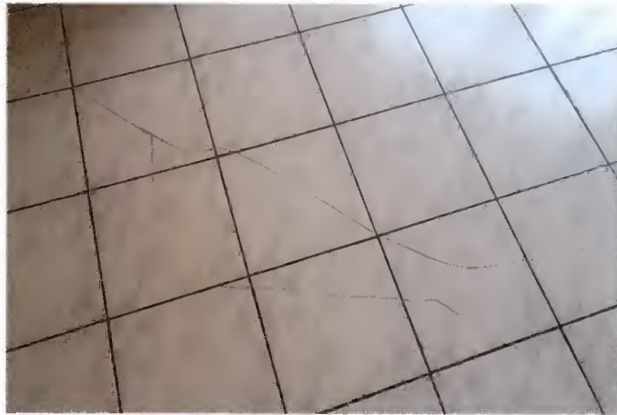
Risse im Fliesenboden
