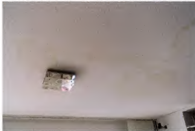
Wasserflecken an der Decke im Wohnzimmer
