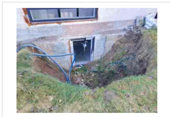
nicht fertig gestellter Lichtschacht
