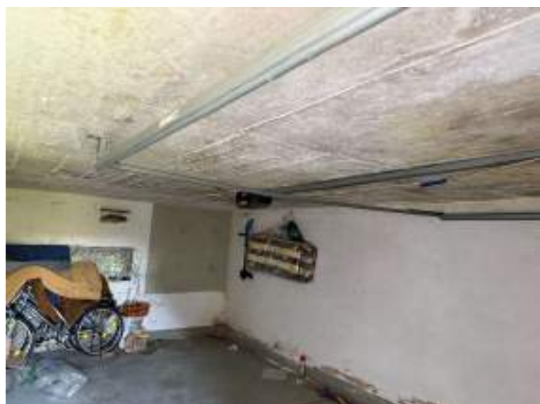
Feuchtigkeit Decke straßenseitige Garage
