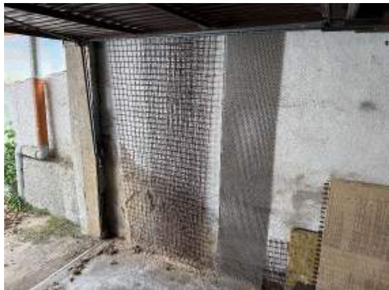
Feuchteschaden rückwärtige Garage
