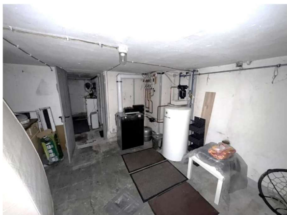
Reihenmittelhaus Kellergeschoss Heizung
