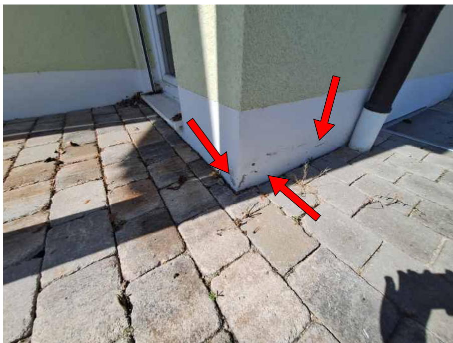
exemplarische Feuchtigkeitsschäden im Sockelbereich
