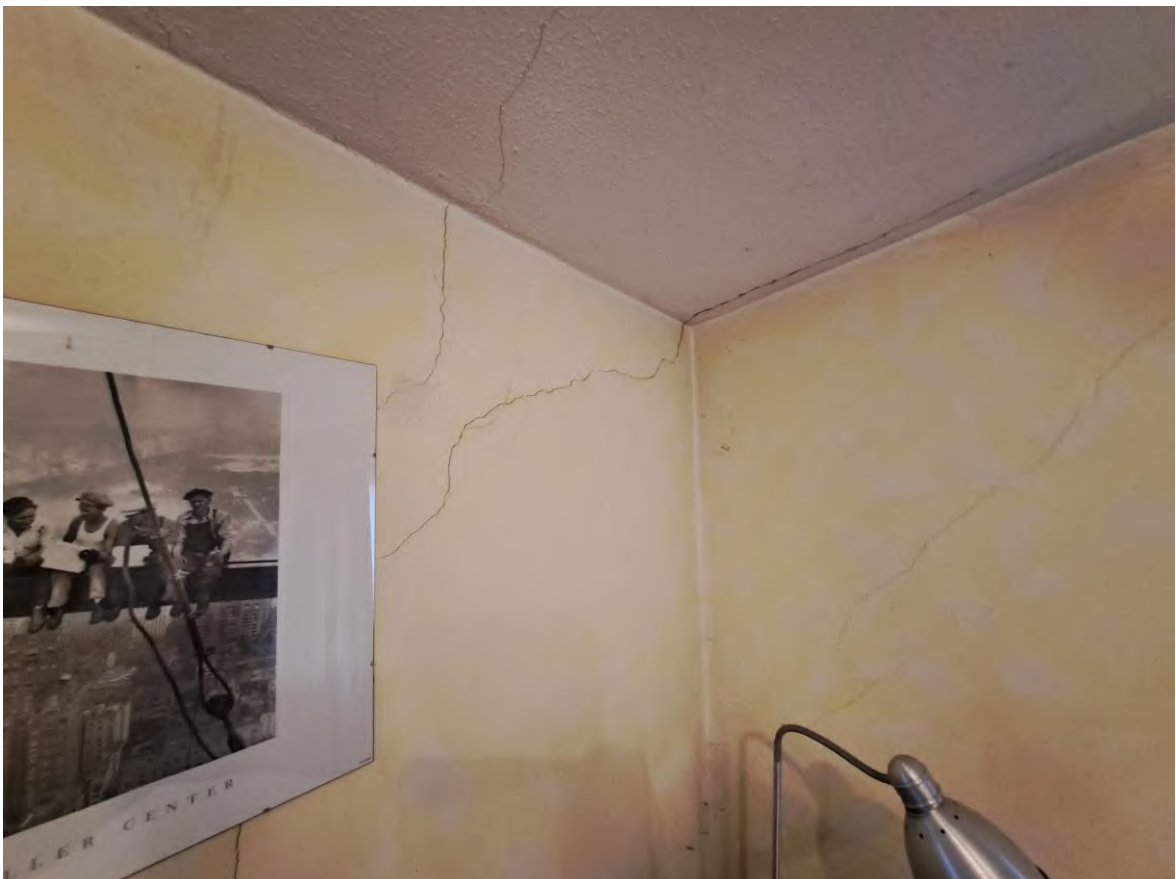
38 Rissbildung an der Raumecke Wohnzimmer, Wohnung Nr. 1 OG
