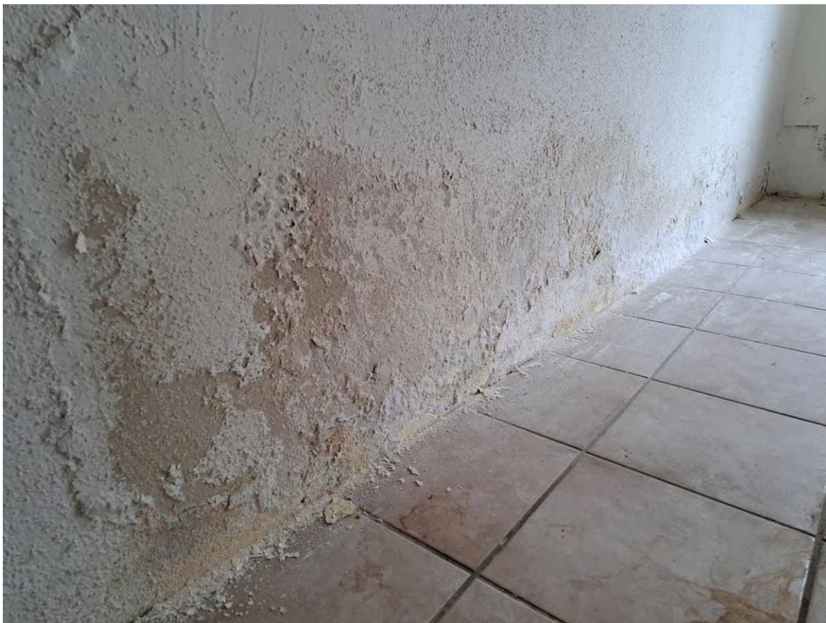
35 Ausblühungen Innenwand, Gewerbeeinheit Nr. 2
