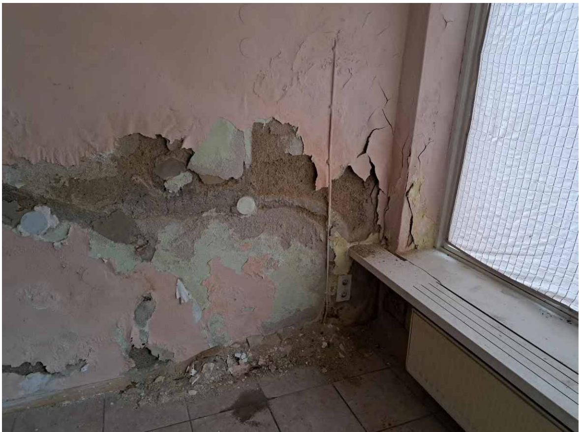
34 Schadensbild an der selben Außenecke, Gewerbeeinheit Nr. 2
