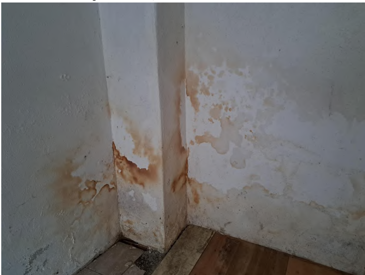
36 Fleckenbildung am Kamin, Hinweis auf mögliche Kaminversottung
