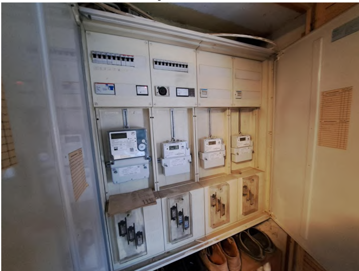
18 Hauptverteilung mit FI-Schutzschalter
