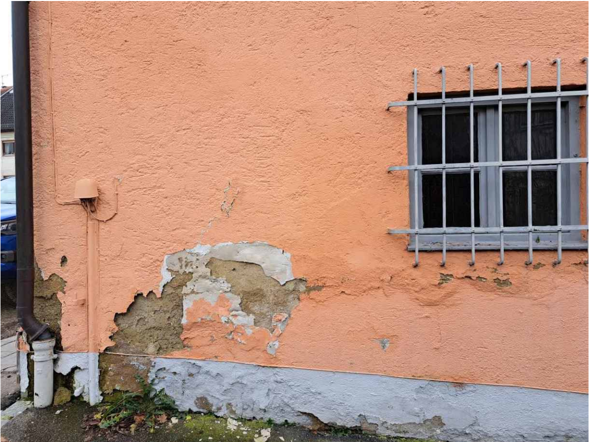
33 großflächiger Schaden am Außenputz
