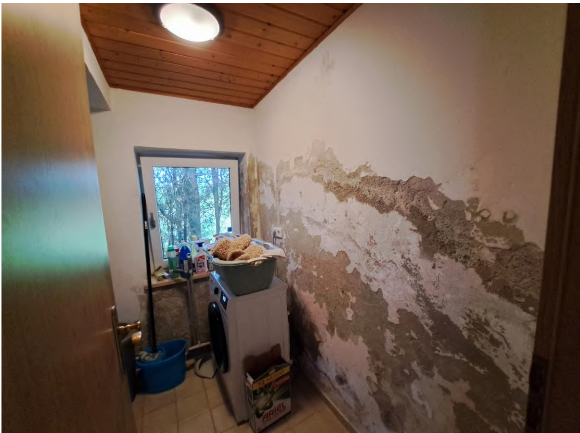
20 Wohnung Nr. 1 EG, Hauswirtschaftsraum mit Feuchtigkeitsschaden
