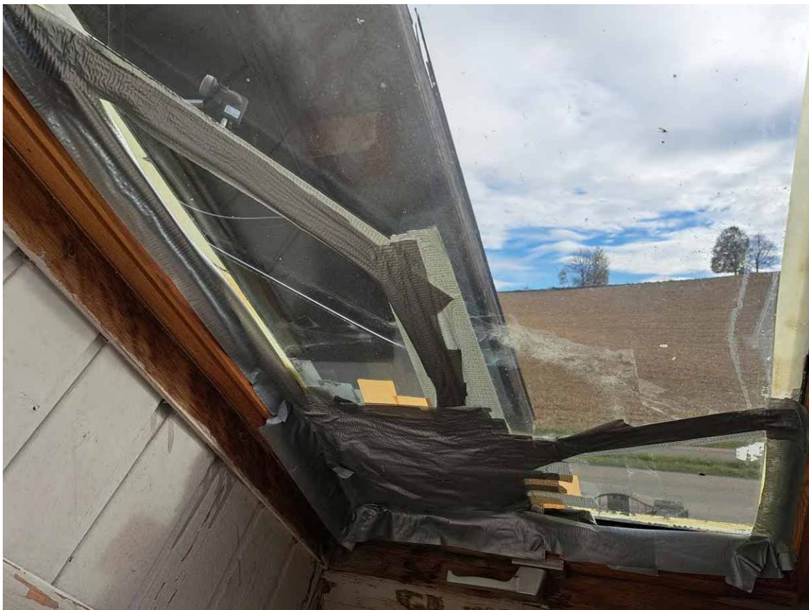
31 Wohnung Nr. 2 DG, defektes Dachflächenfenster
