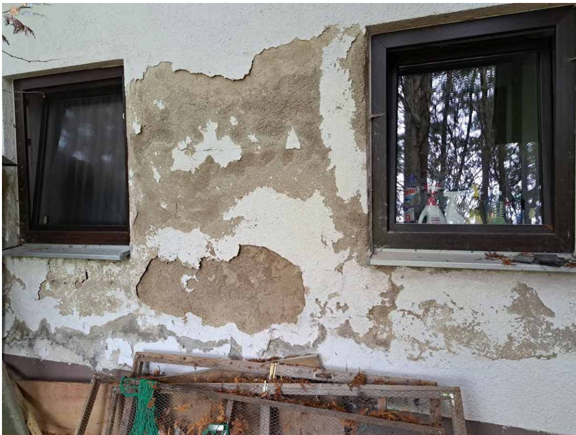
33 großflächiger Schaden am Außenputz beim Hauswirtschaftsraum
