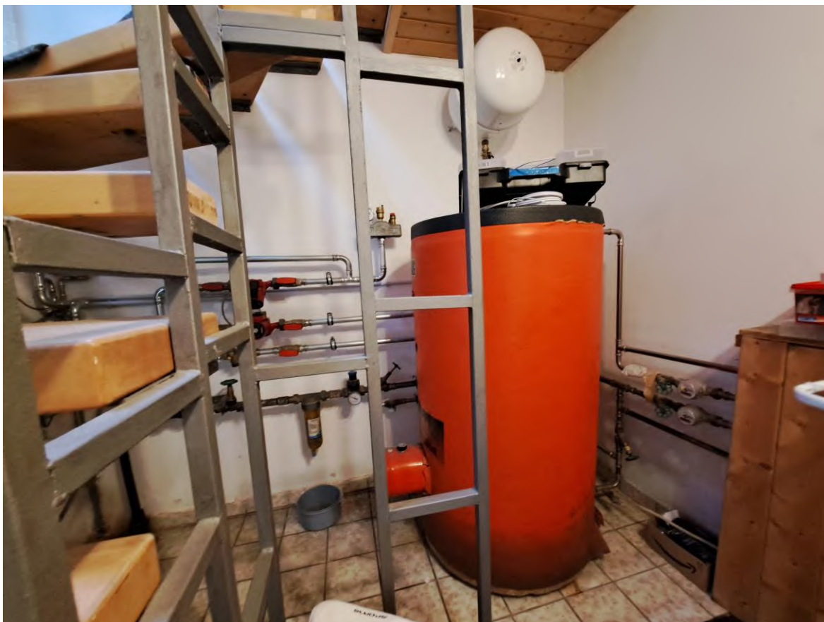
17 Warmwasserübergabestation (Fernwärme) und Warmwasserspeicher 300 Liter
