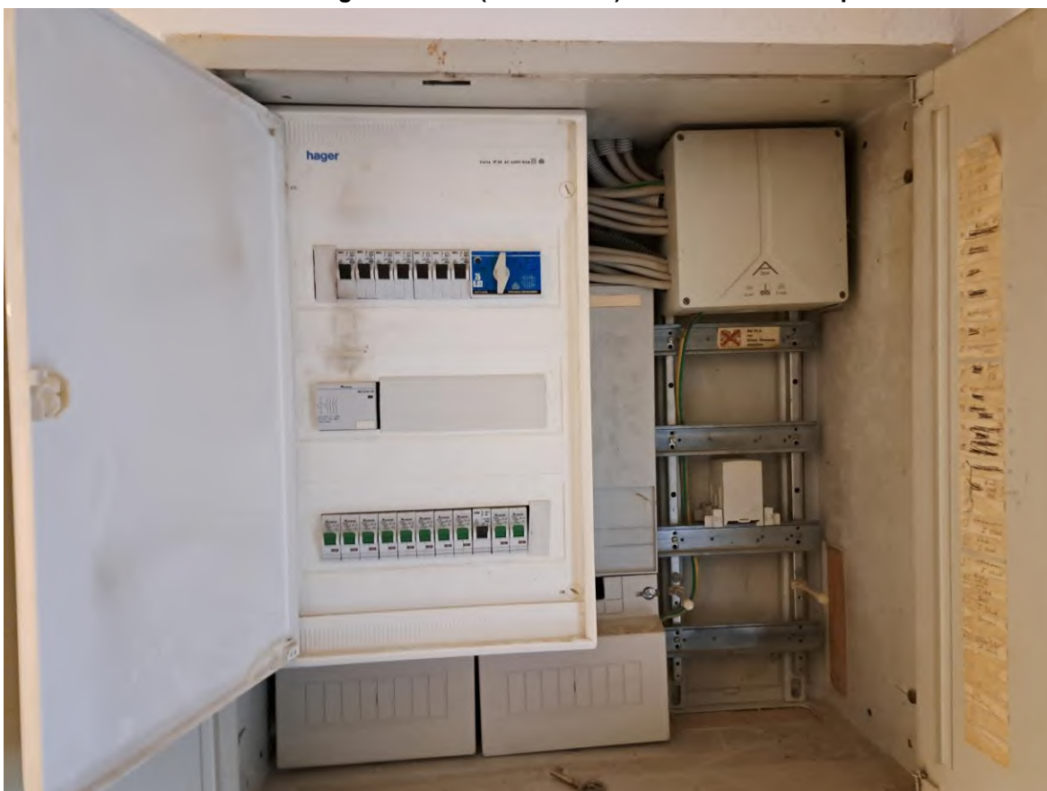
18 Wohnung Nr. 1 EG, Unterverteilung mit FI-Schutzschalter
