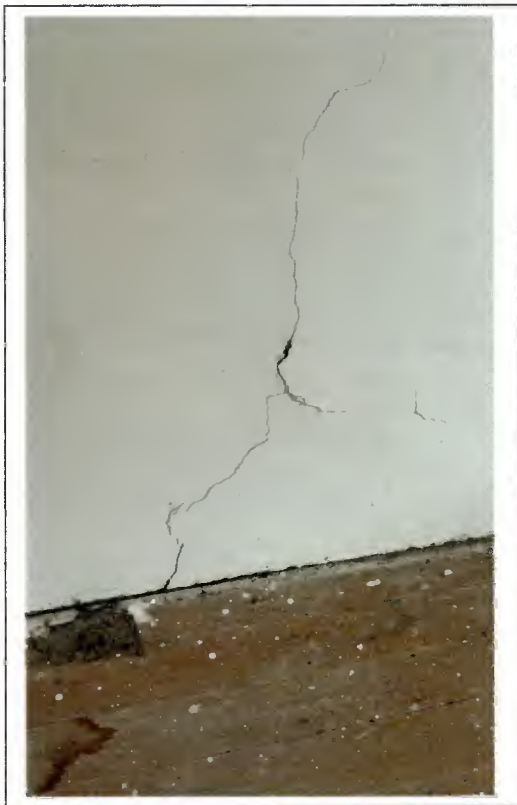
Foto 22: Risse an der Wand
