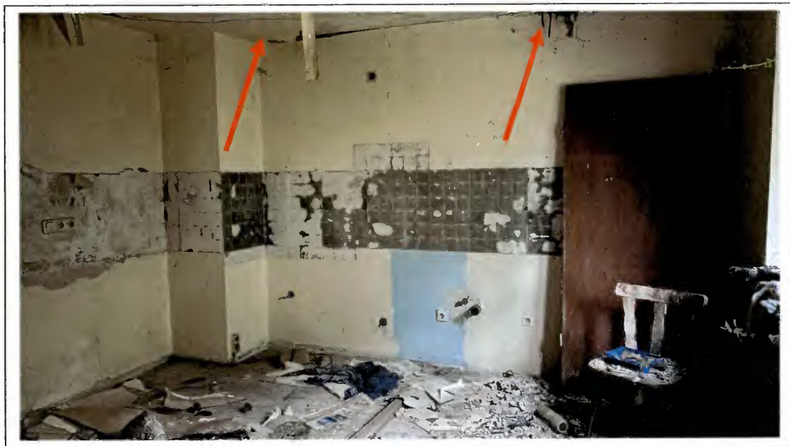
Foto 13: Blick in die Küche; defekte Decke
