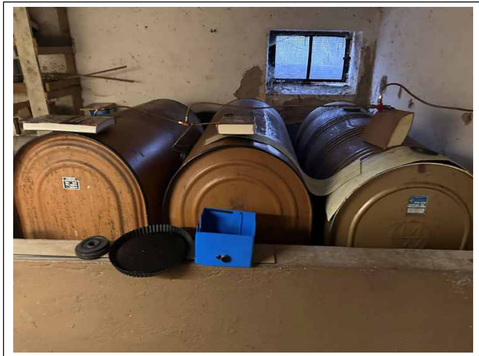
Foto 17: Blick in den Tankraum
