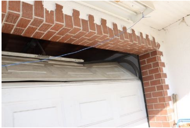
beschädigtes oberes Garagentor
