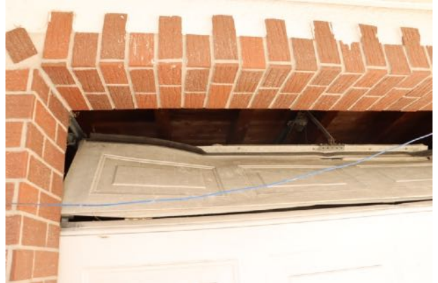
beschädigtes oberes Garagentor
