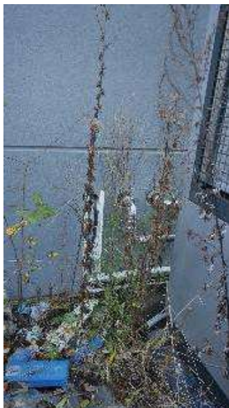
Bild 63: Bauschäden / Unterhaltungsstau (Beispiel)
