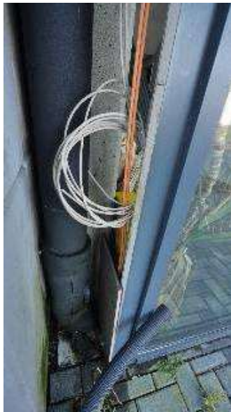
Bild 61: Bauschäden / Unterhaltungsstau (Beispiel)
