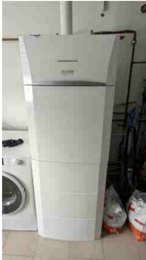
Bild C1 Beispiel Haustechnik Therme, Hersteller Remeha
