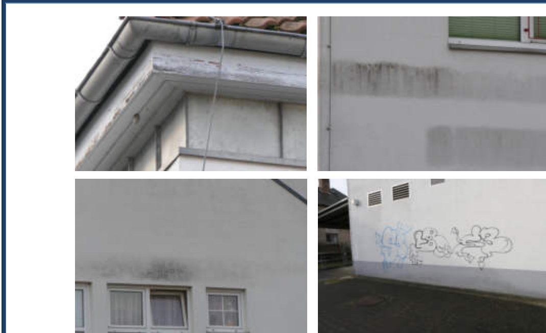
Abbildung 27: Detailansichten der Fassade; tlw. verschmutzte Fassadenflächen; tlw. verwitterte Holzbauteile
