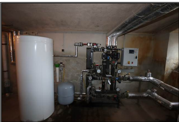
Fernwärmeanschluss im Kellergeschoss
