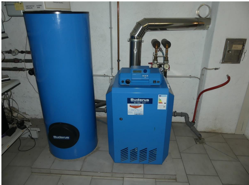
Foto 12: Heizung im Keller
