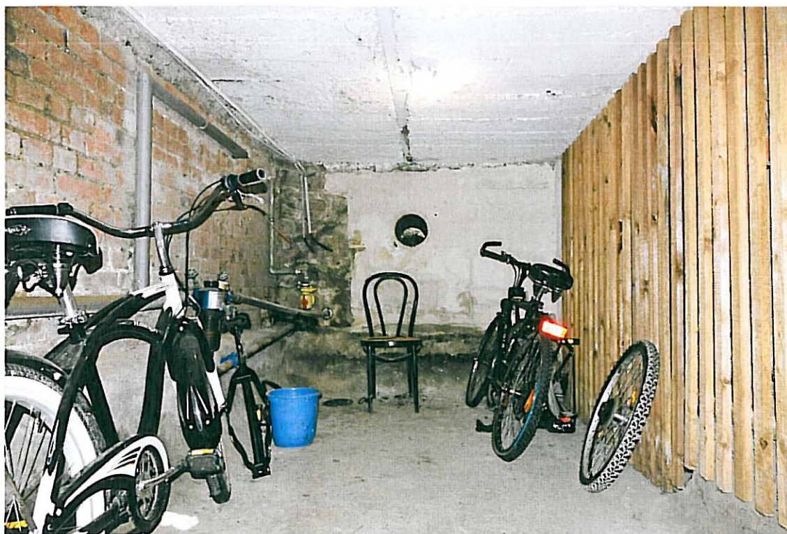
Wohn-/Geschäftshaus, KG, Hausanschlussraum
