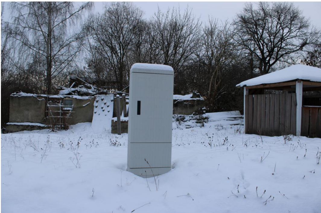
Foto Nr. 3: Stromkasten, Unterstand, grenztändige Gebäuderuine auf Nachbargrundstück Flurstück 12a
