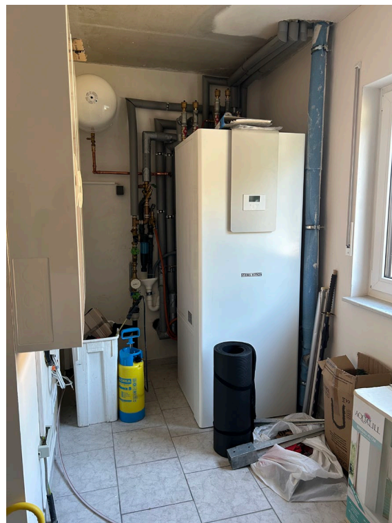
Abb. 10 Erdgeschoss, Teilansicht Hausanschlussraum mit Heizungsanlage
