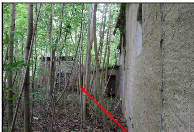
Ost-Ansicht der baufälligen, abzubrechenden baulichen Anlagen
