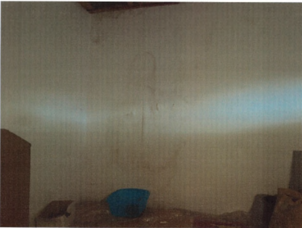
Wand Zimmer 2 mit Feuchtespuren
