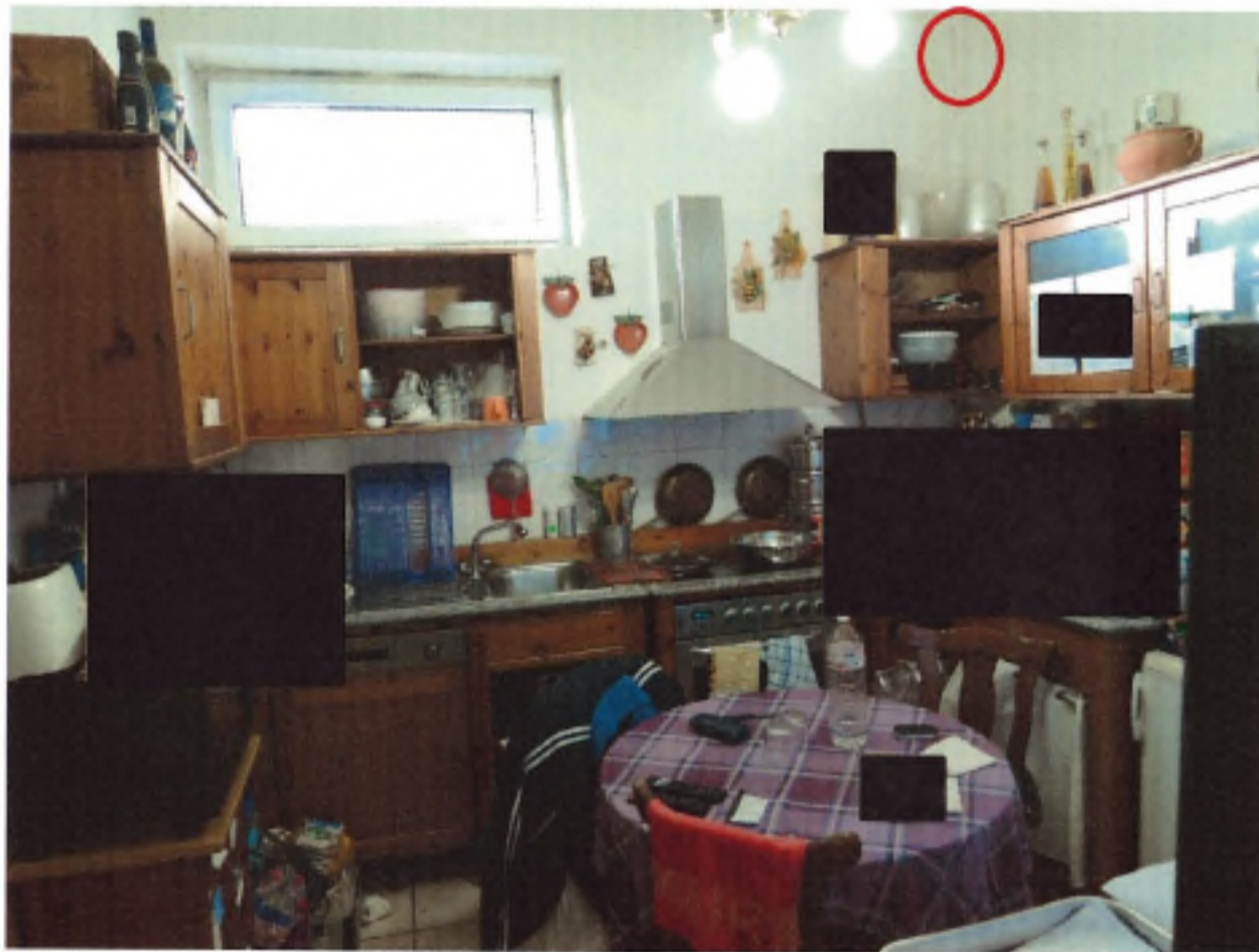
Küche, Feuchtespuren/Schimmel (siehe Markierung)
