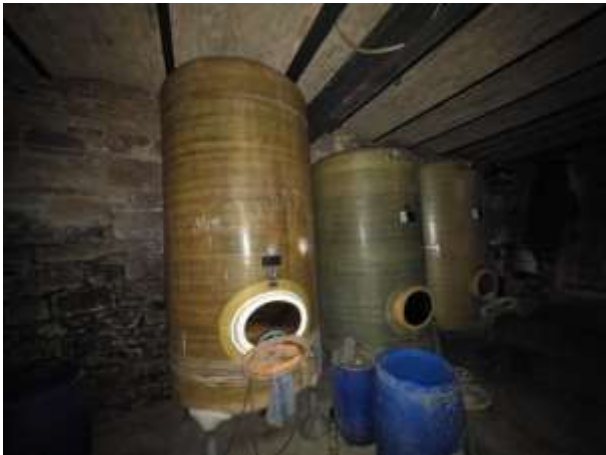
Bild 11 – GFK Tanks groß
