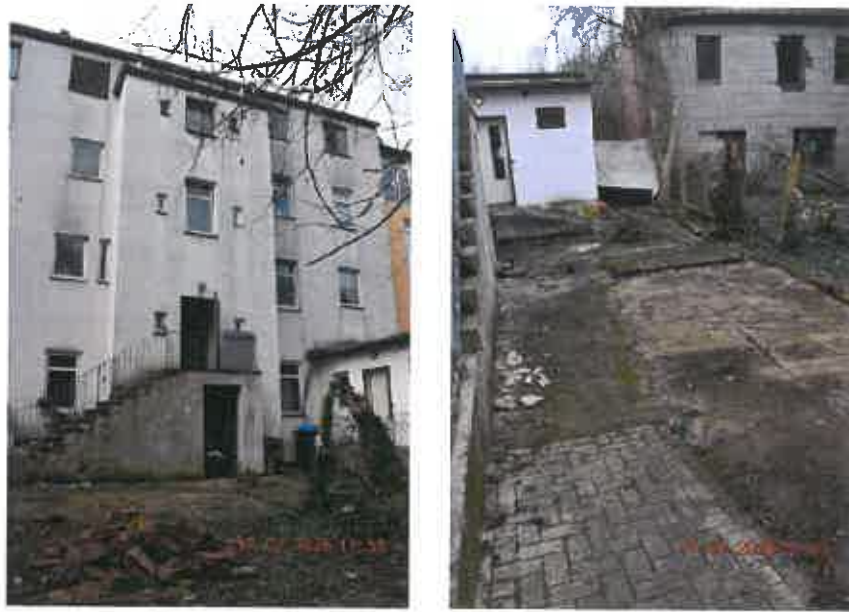
rückwärtige Ansicht mit schadhafter Außentreppe und Hoffläche und eingeschossigem Anbau
