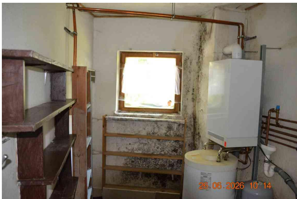
Bild 16: Heizraum mit Feuchteschäden
