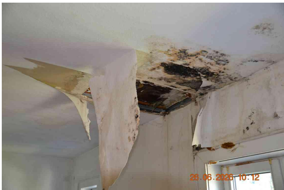
Bild 10: Feuchteschäden im Obergeschoss
