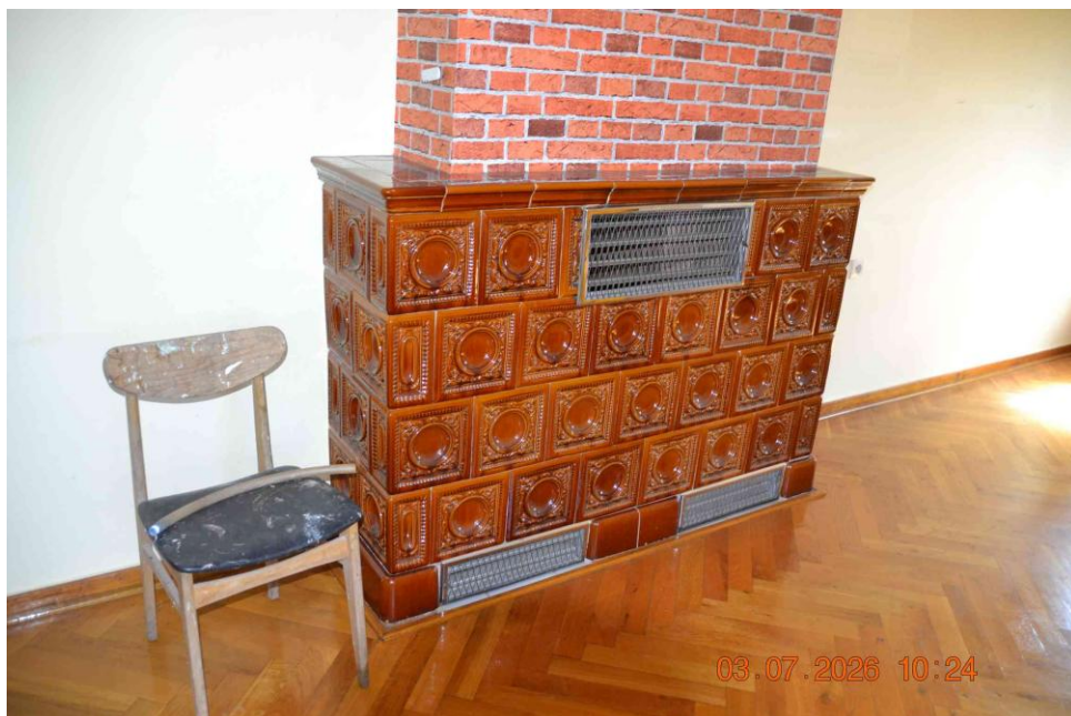
Bild 12: Wohnzimmer Erdgeschoss Warmluftofen
