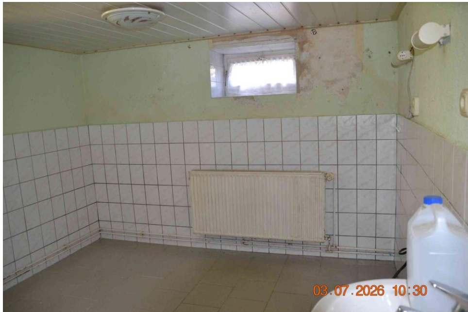
Bild 17: Kellerraum mit Feuchteschäden
