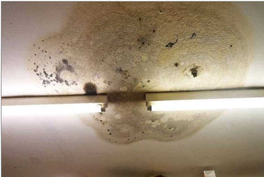
Foto 14 - ehemaliger Laden - Decke mit Feuchteschaden und Schimmelbefall
