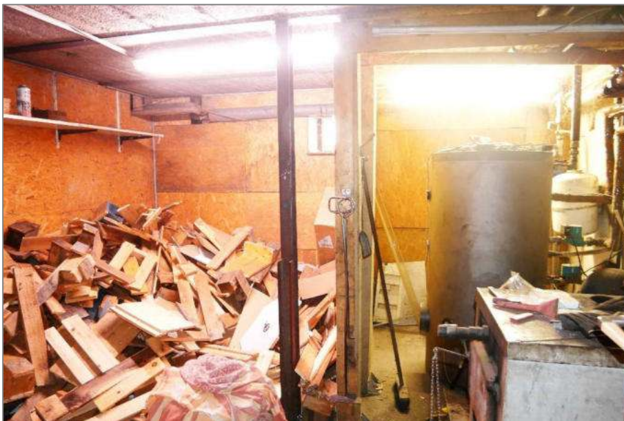
Foto 4 - Wohnhaus - Heizraum KG
