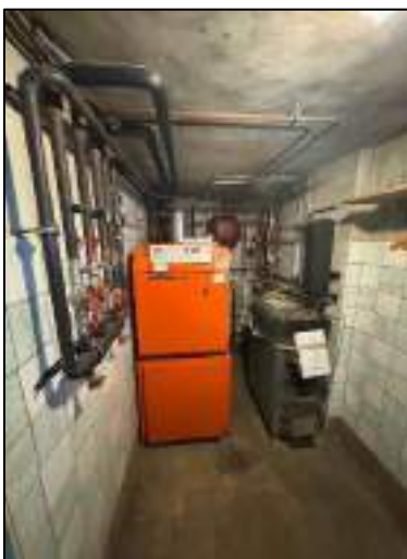
Heizungsraum mit Gasheizung von 2000
