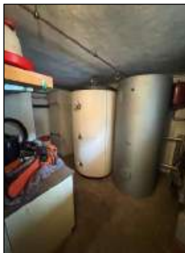
Warmwasserspeicher der Solarthermie von 2000/2001
