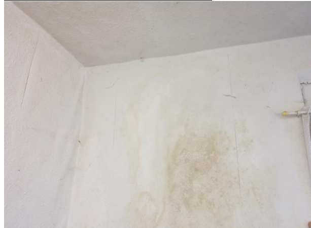
Schadensfoto Wasserschaden EG
