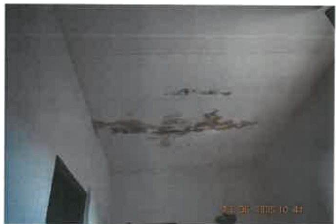
schadhafte Decke im Nebenraum
