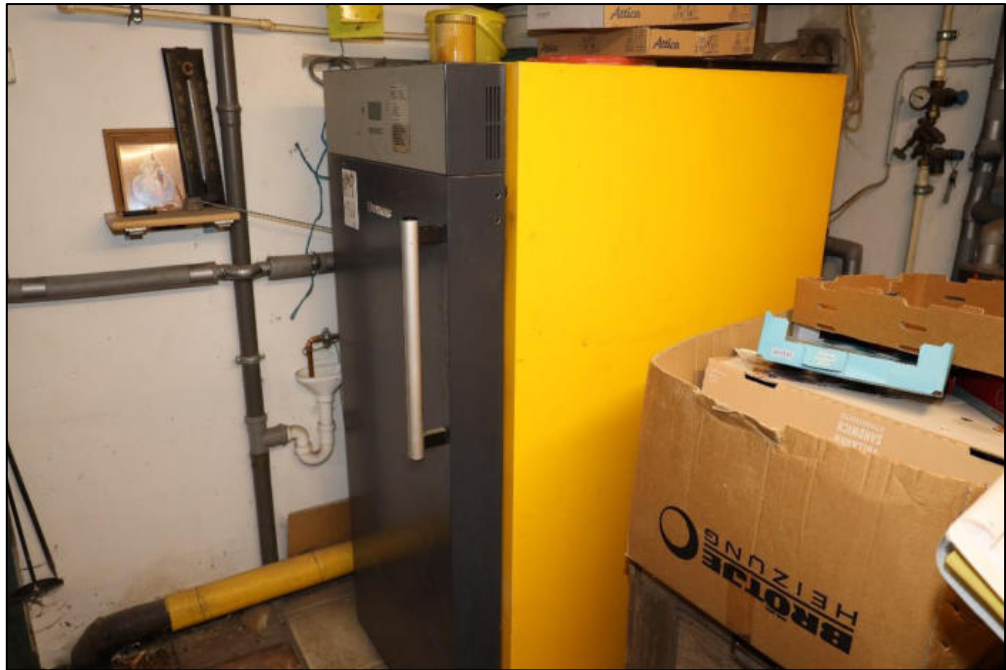
Heizung (Fremdeigentum) – Kellergeschoss
