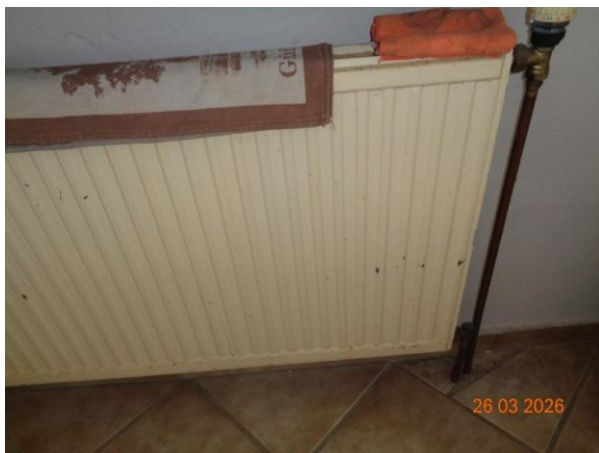
Bild 15: Heizkörper (vor 1990) in Küche mit partieller Korrosion
