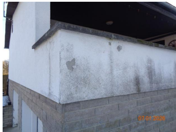
Bild 4: Putzschäden und Fassadenverschmutzung westseitig im Bereich der Terrasse
