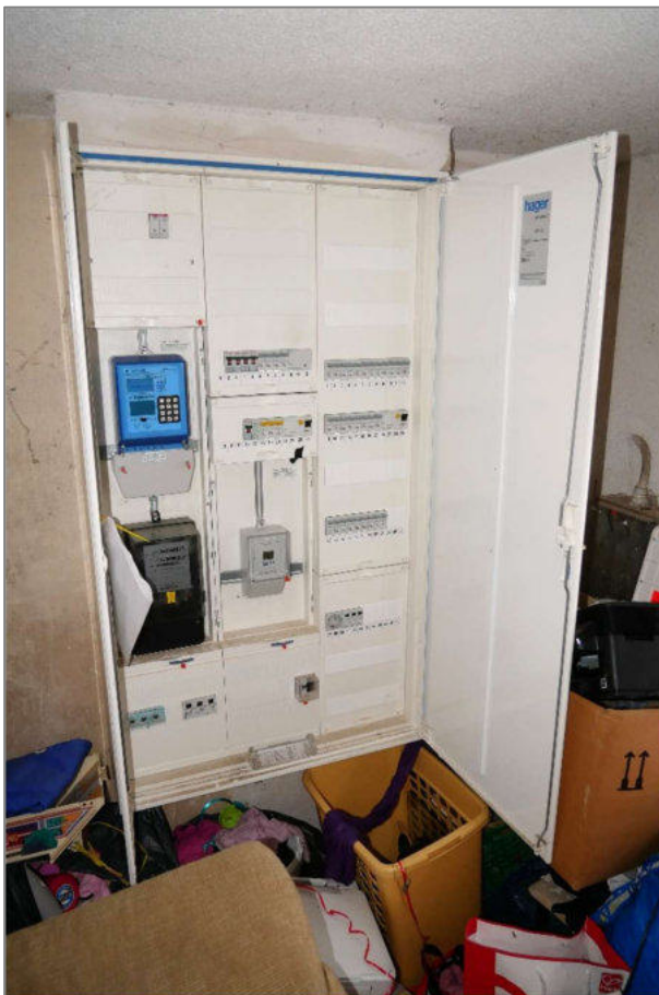
Foto 8 - Wohnhaus - Elektroverteilung im Flur EG
