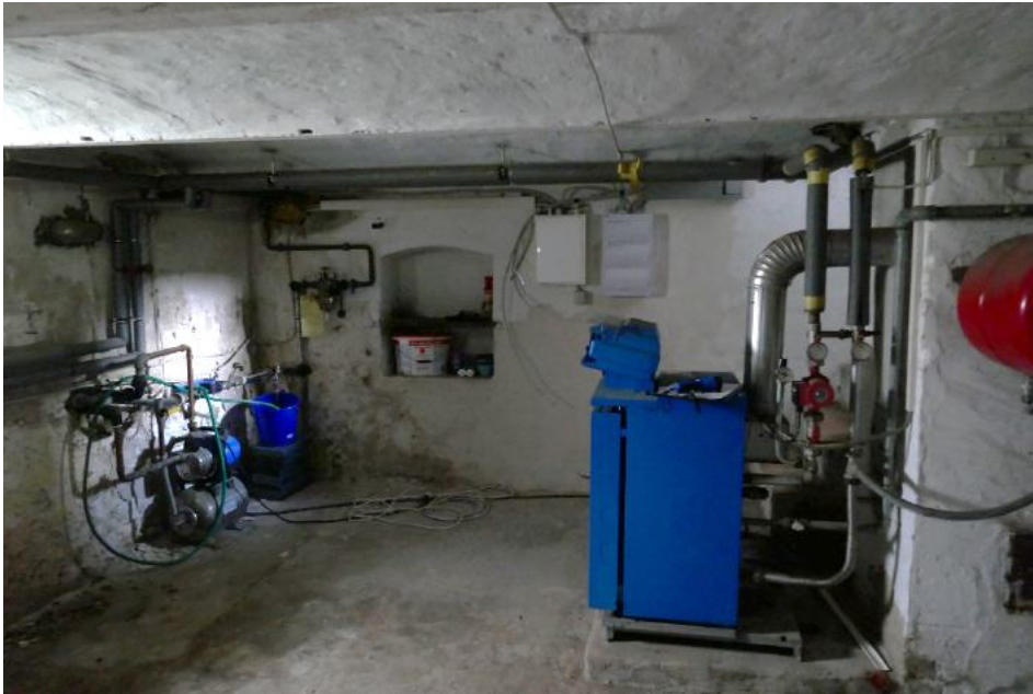
Foto 17, Teilkeller (TK), Kellerraum mit Gaszentralheizungskessel
