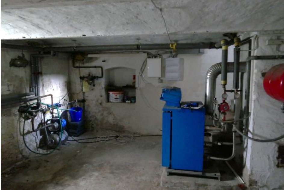
Foto 17, Teilkeller (TK), Kellerraum mit Gaszentralheizungskessel
