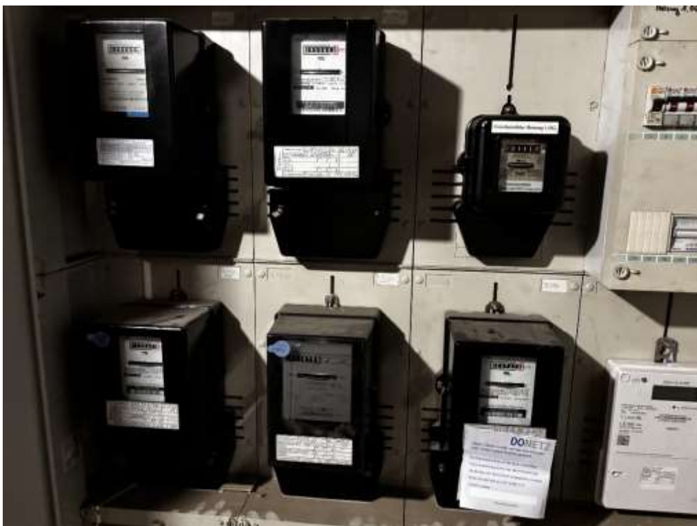
Zählerkasten im Keller
