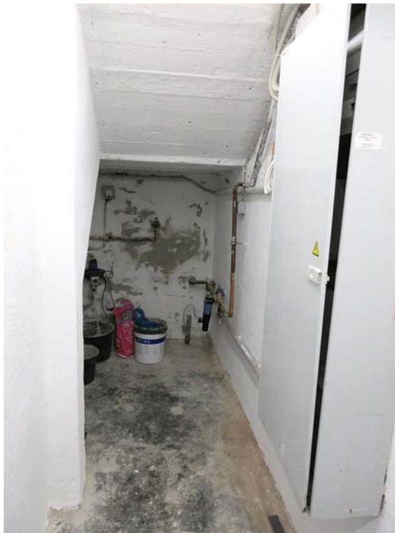
Feuchte an Außenwand Gebäudefront
